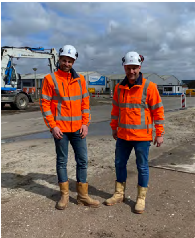
Links Thomas Snelderwaard en rechts Herman Haaksma bij de wegwerkzaamheden aan de Middenweg
